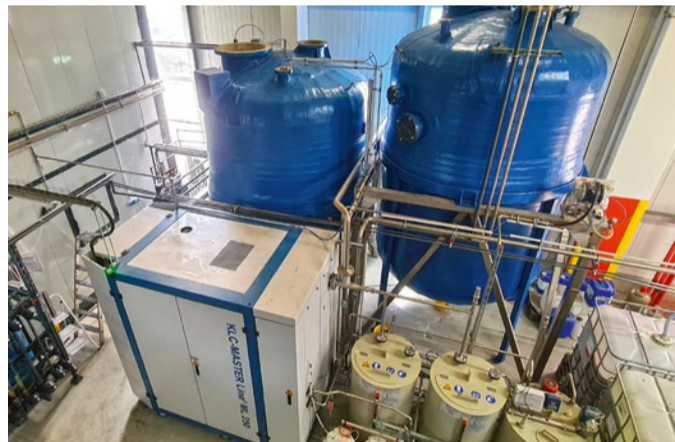
Die Vorbehandlungsanlage ist jetzt mit einer Abwassertechnik für die Aufbereitung der Prozessabwässer ausgestattet.
