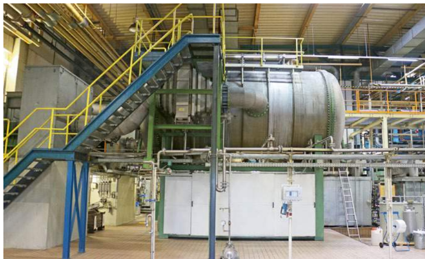
Derzeit sorgt bei VW in Salzgitter ein Röhrenverdampfer für die zentrale Aufbereitung der industriellen Abwässer. Pro Tag verarbeitet die Anlage im Durchschnitt rund 90 m 3 ölhaltiges Abwasser.
